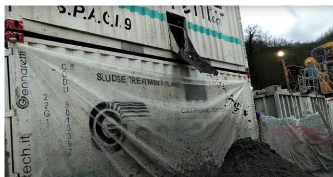
Figura 12. Scarico solido dalla centrifuga
