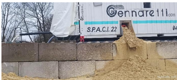
Figura 4.b Scarico solido in disidratazione
