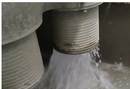
Figura 4.a Scarico liquido in disidratazione
